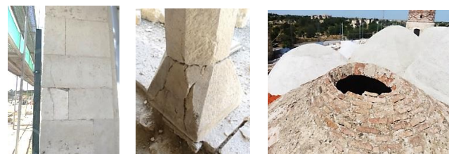
Şəkil 5. Müşahidə olunmuş zədələrin xarakteri və çatlar [5]
