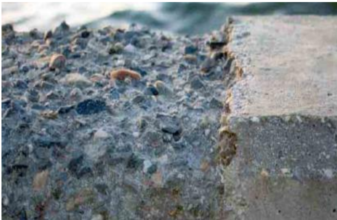
Şəkil 1. Dəniz suyu təsirindən betonun görünüşü
