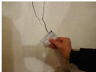
Şəkil 6. Çatların eninin təyin olunması
