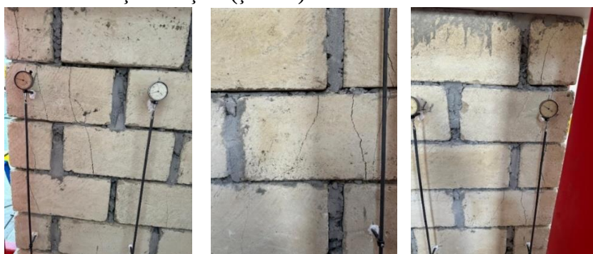
Şəkil 4. Mərkəzi sıxılmada sərt rəbitəli boşluqlu divar nümunələrində çat və zədələr.
