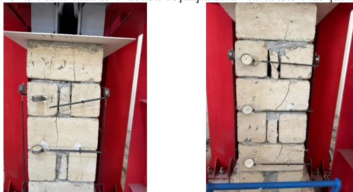
Şəkil 5. Sərt rəbitəli boşluqlu divar nümunələrinin sərt rəbitələrində çatlar
