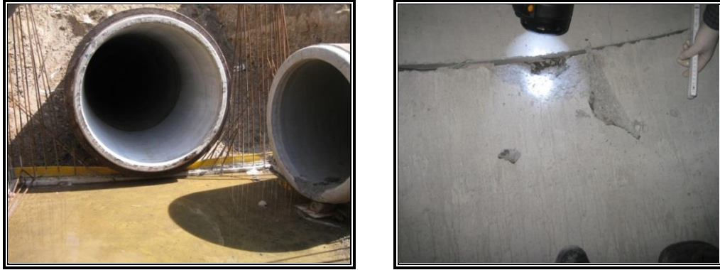
Şəkil 3. Gəncə bölgəsində yerləşdirilən Ø1200-1600 mm olan boruların daxili səthindəki qopmalar və çatlar
