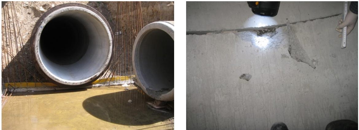
Şəkil 4. Gəncə bölgəsində yerləşdirilən Ø1200-1600mm boruların daxili səthindəki qopmalar və çatlar.
